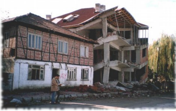
Costruzione turca himis rimasta in piedi nel 1999 a seguito di sisma. Accanto edificio moderno collassato perché mal costruito.
