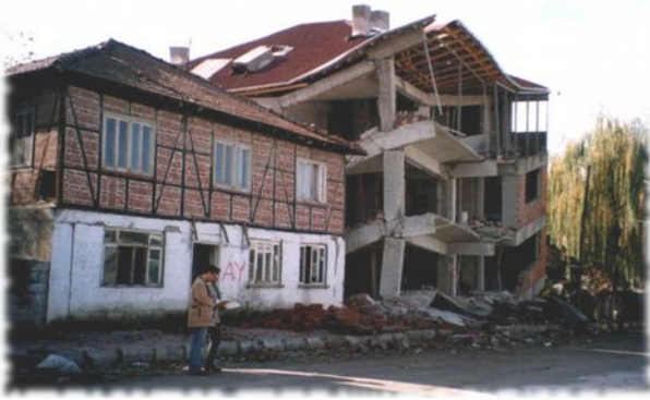
Costruzione turca himis rimasta in piedi nel 1999 a seguito di sisma. Accanto edificio moderno collassato perché mal costruito.
